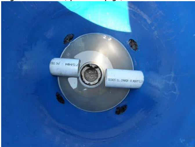
Regard de collecte (après nettoyage)
