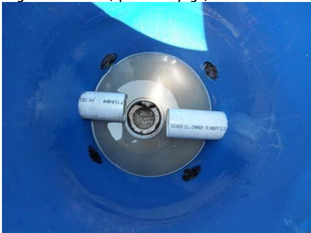
Regard de collecte (après nettoyage)
